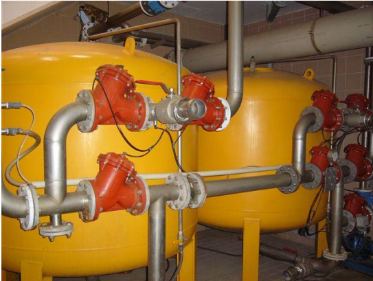
Equips de filtració multicapa a pressió
